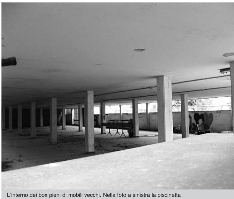
L'interno dei box pieni di mobili vecchi. Nella foto a sinistra la piscinetta
